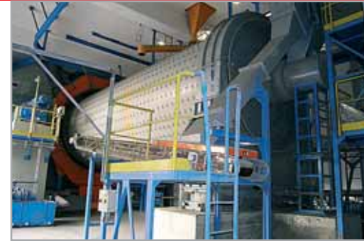
Цех помола цемента с мельницей \varnothing 4,0 \times 13,75 \text{ м} с посадкой на сегментных подшипниках
