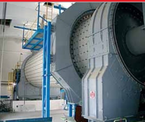
Цех помола цемента с мельницей Ø 4,0 x 13,75 м с посадкой на сегментных подшипниках
