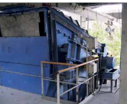
Hrubotřídíč HT2045 - třídění spilitu, břídlíce, tufitu
