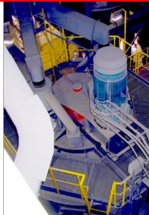
Vzduchový třídíč VTP 2700 v mlýnici cementu 80t/h – cementárna CEMMAC Horné Srnie, Slovensko
