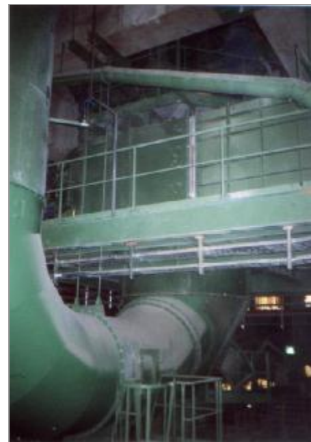
Spodní část vzduchového třídiče VTP 2900 s odtahovým potrubím ve mlýnici cementu 130 t/h – cementárna Anhovo, Slovinsko.
