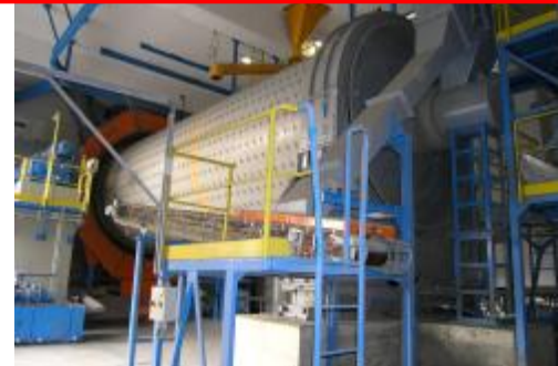
Mlýnice cementu s mlýnem \text{Ø } 4,0 \times 13,75 \text{ m} uloženým na segmentových ložiskách
