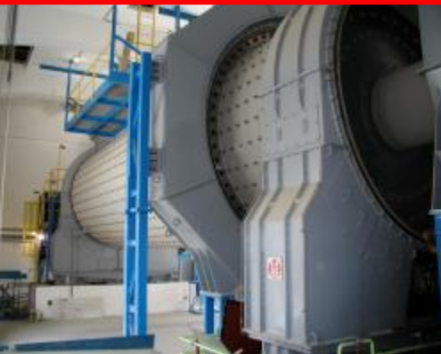
Mlýnice cementu s mlýnem Ø 4,0 x 13,75 m uloženým na segmentových ložiskách
